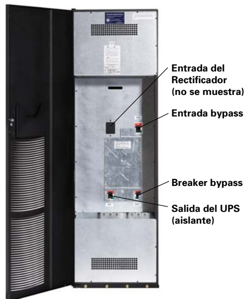
Bypass de Mantenimiento AC-B (160 kVA)
